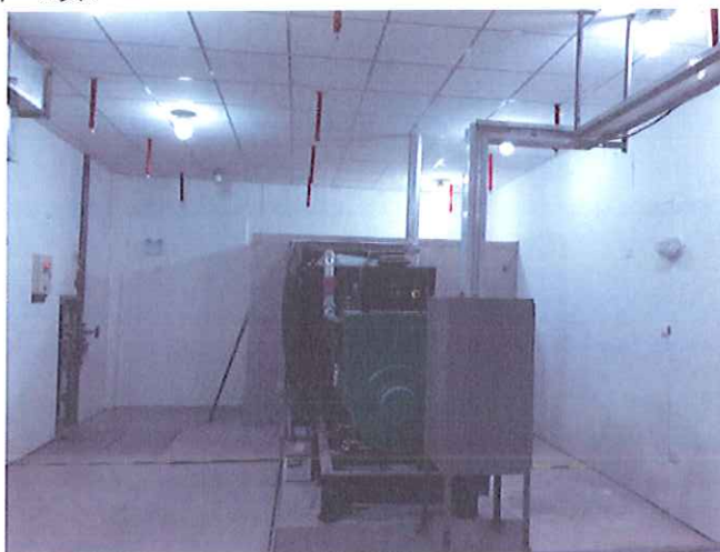
发电机房降噪及排烟管道
